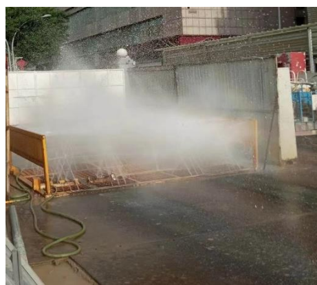
安定门站出入口车辆冲洗台
