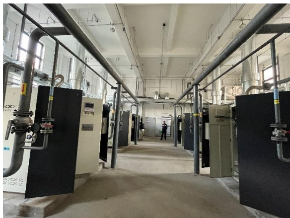
停车场低氮冷凝燃气锅炉
