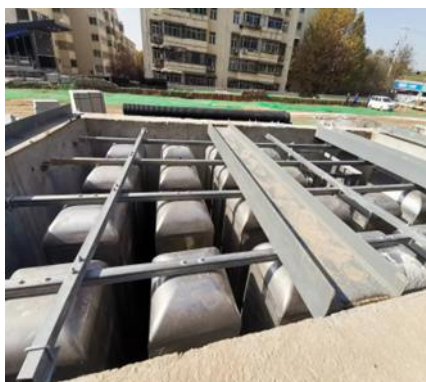
纺六路站风亭内安装的消声器
